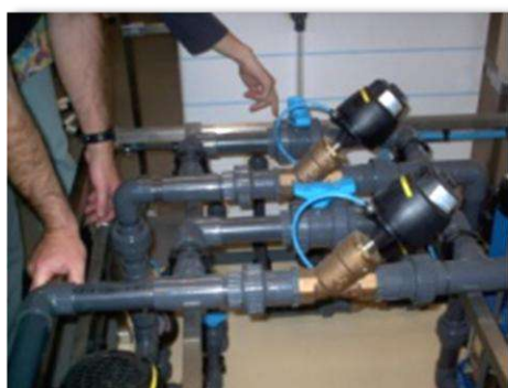
Banc de pompage automatisé
